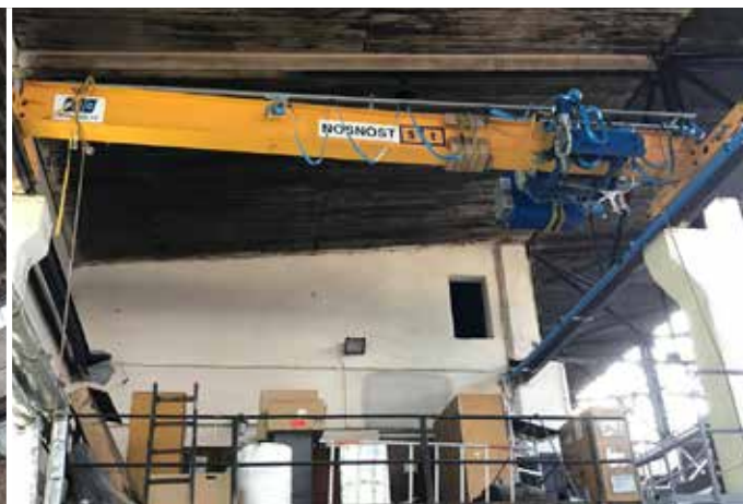
Jeřáb mostový jednonosníkový 5t - 6,8m - České dráhy, a.s.
