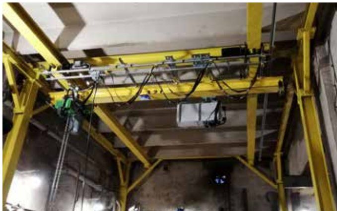
Jeřáb podvěsný 3,2t - 3,5m - U. S. Steel Košice, s.r.o.
