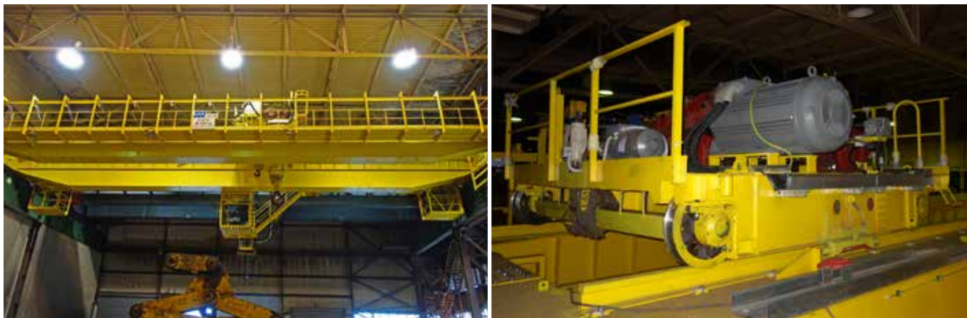
Jeřáb mostový 46t/12,5t - 28,2m - U. S. Steel Košice, s.r.o.
