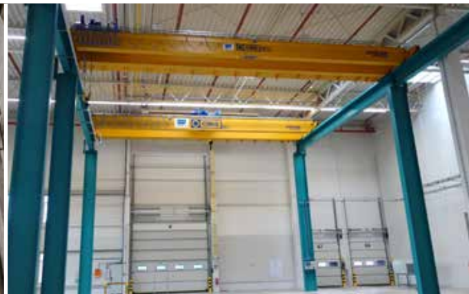
Jeřáb mostový dvounosníkový 10t - 14,5m - Schenck Process s.r.o.
